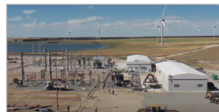
Parque Eólico Pampa Energía II
