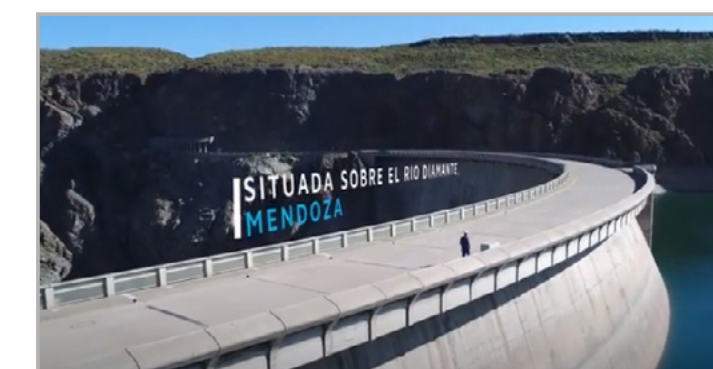
Central Hidroeléctrica Diamante
